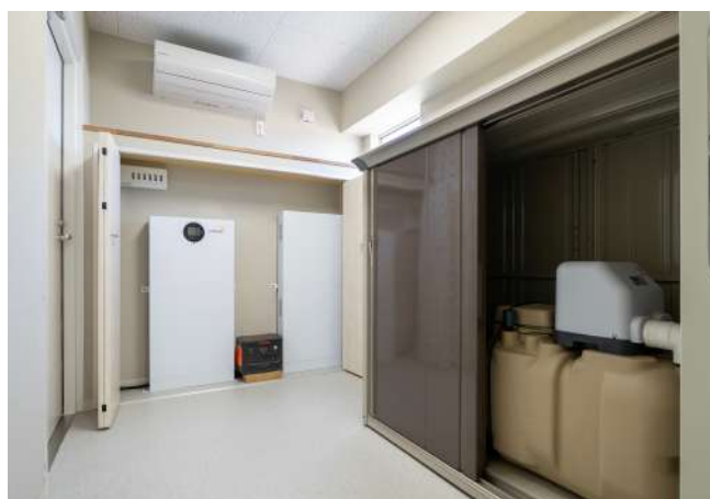
蓄電池と給水設備
